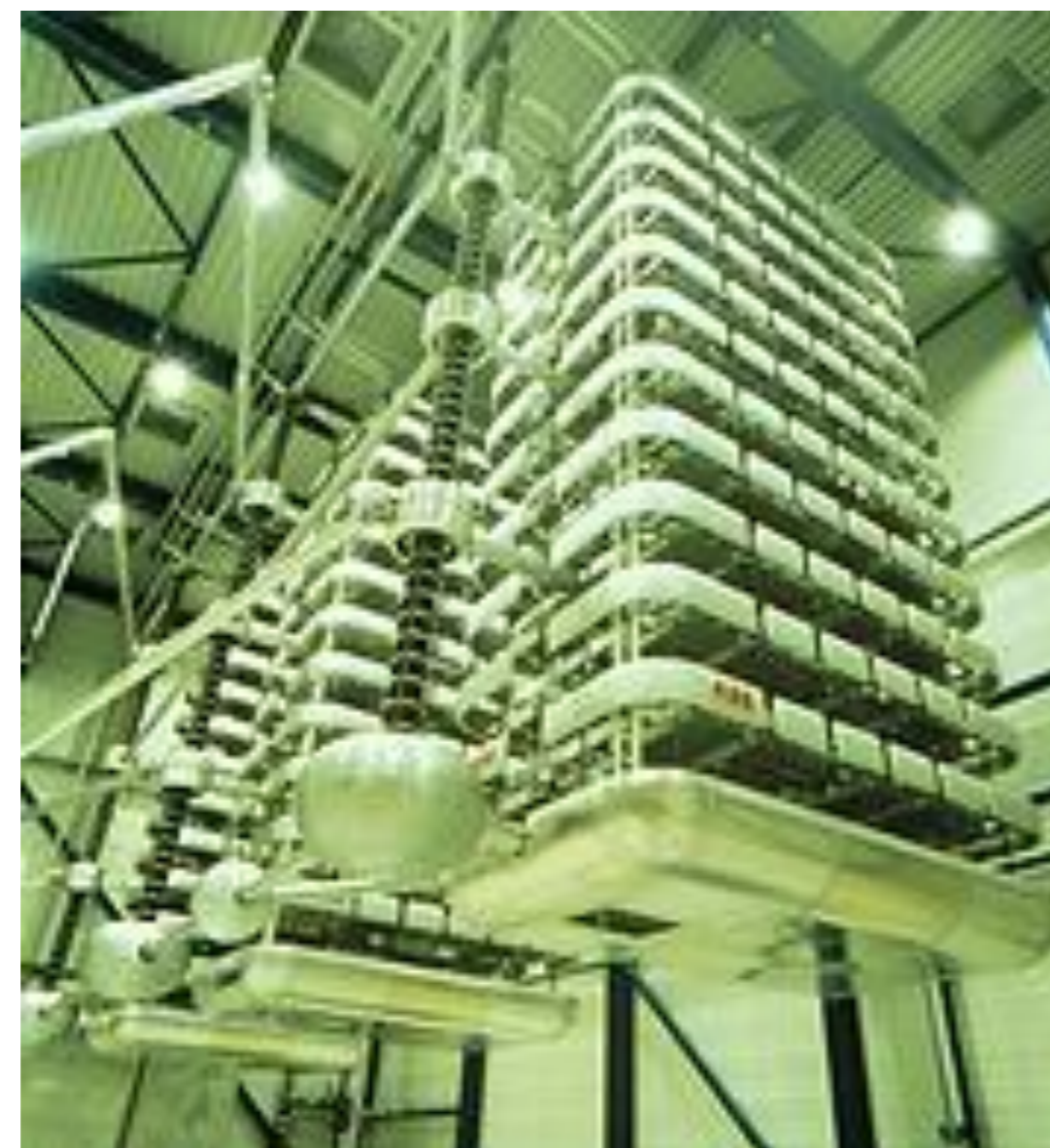
Sala de válvulas, proyecto ABB
